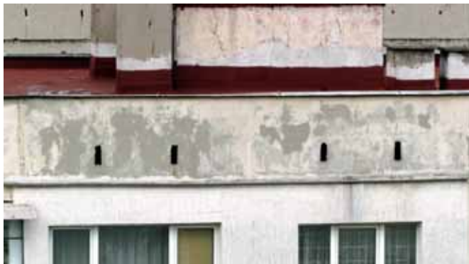
Τρύπες σε προσόψεις προκατασκευασμένων κτιρίων, προσβάσιμες για νυχτερίδες © R. Mecheva
