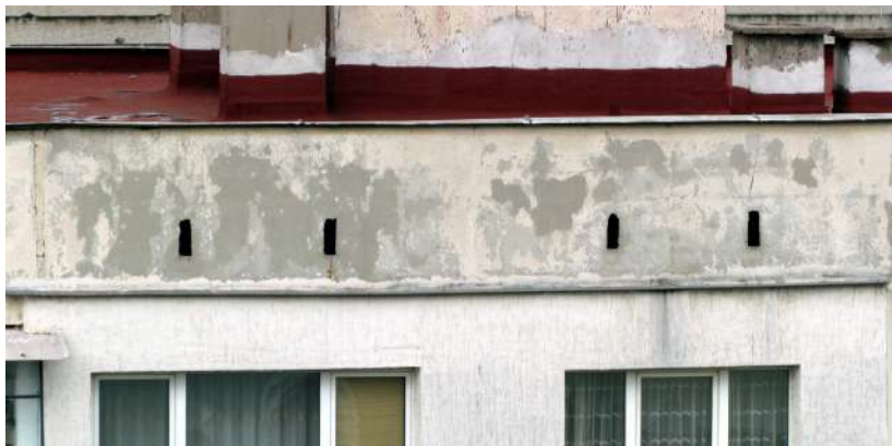
Отвори във фасадите на панелни сгради, достъпни за прилепите
