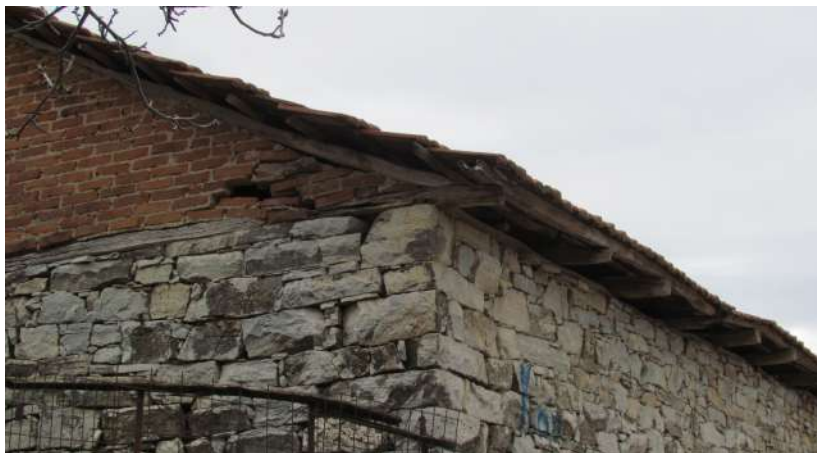
Подходящ отвор за проникване на прилепи в тавана на стара къща
