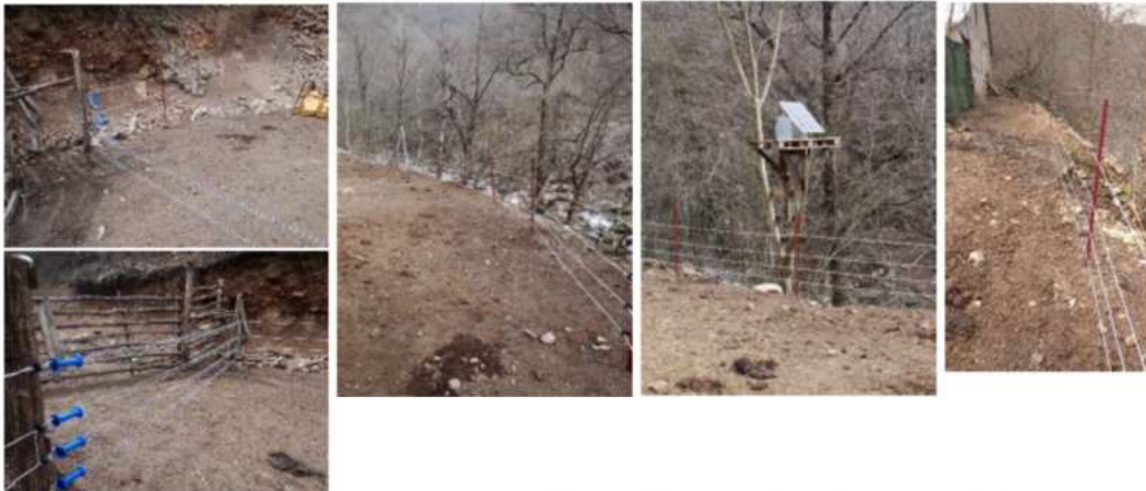
Φωτ. 11-15. Η εγκατάσταση της ηλ. περίφραξης στη σάνη του κ. Μουσά Ορχάν σε σχήμα Π
